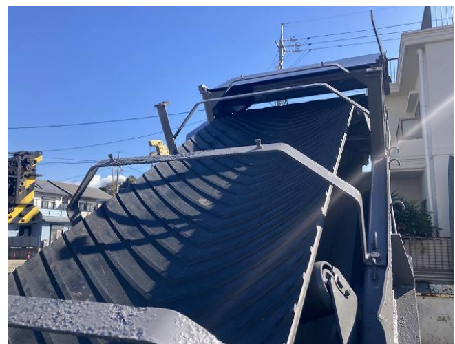
防塵シート欠損
