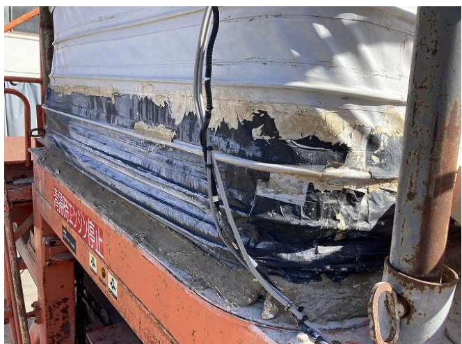
固化材ホッパー補修跡
